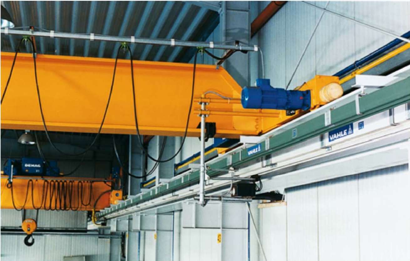
Пластмассовый шинопровод для электропитания цехового крана.
