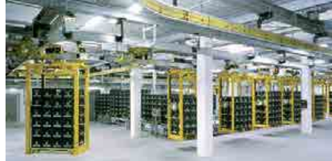
Мультиполюсный шинопровод программы 0811 для электрификации монорельсовой системы на пивоваренном заводе.
